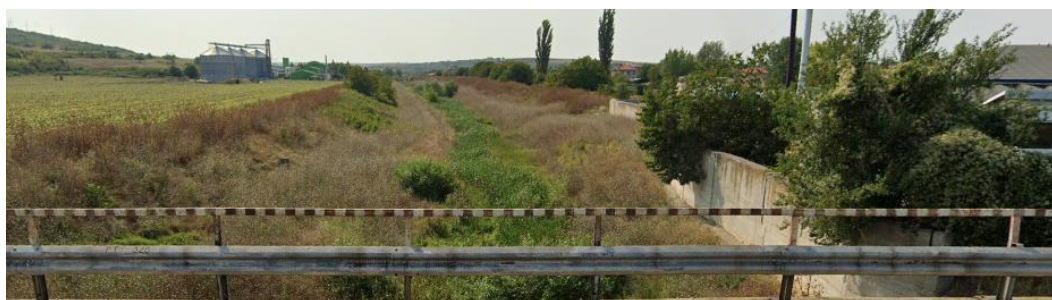
гр. Каспичан, край града по течението, след вливането с р. Мадара; местен път до Каспичан; защитна стена на левия бряг (поглед нагоре по течението)
