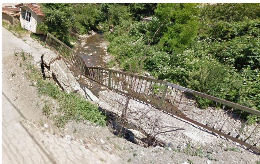
р. Глоговар. Разрушено брегово защитно съоръжение
