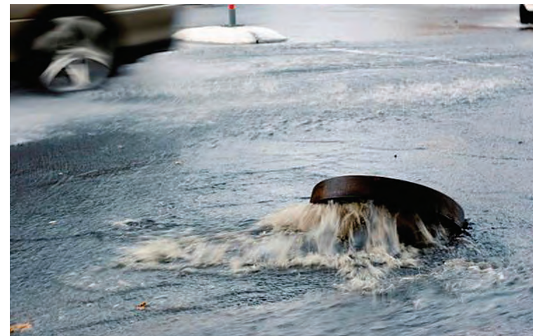
Наводнение от замърсена вода от преливаща канализационна система
