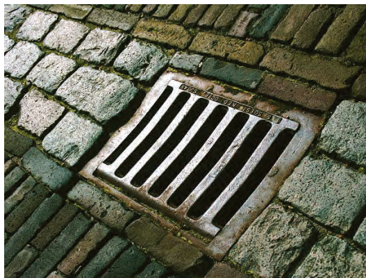
Дъждоприемна шахта за улично отводняване
