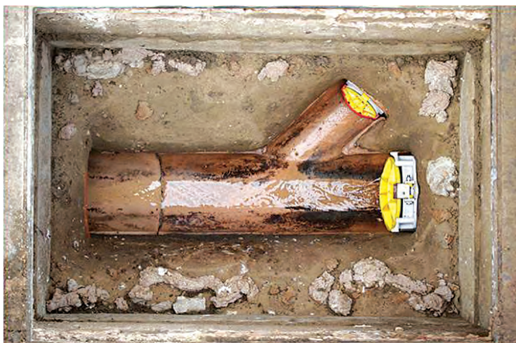
Възвратна клапа на канализационна тръба от сградната инсталация
