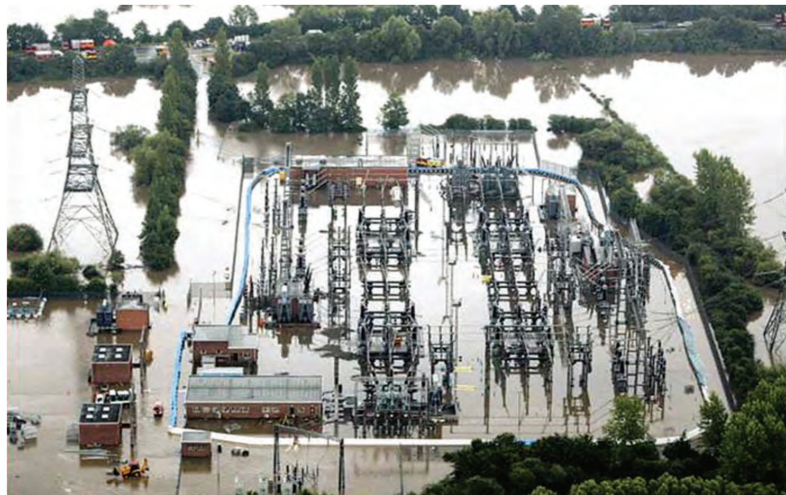
Наводнена електрическа подстанция
